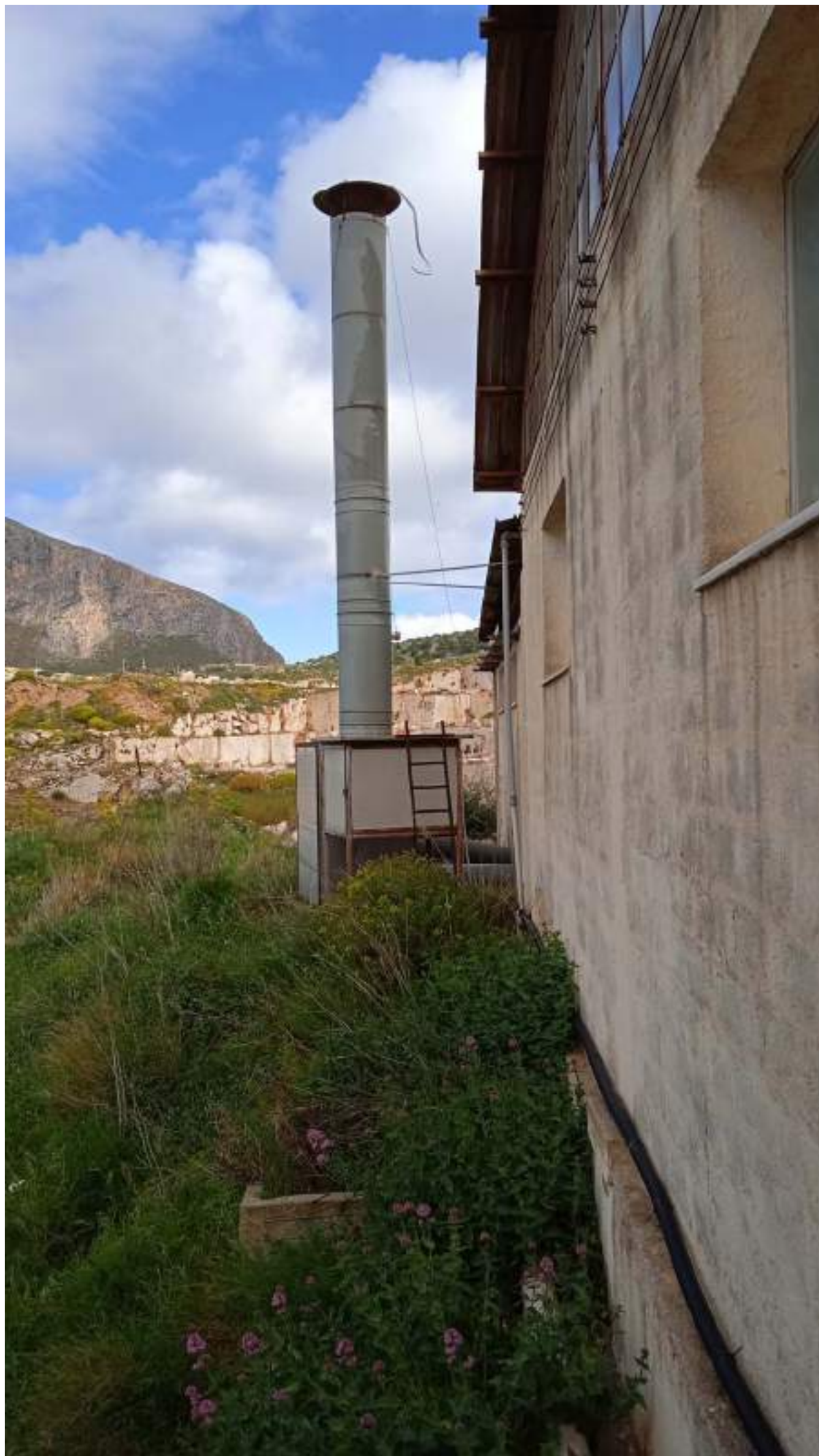
31. Impianto aspirazione CERAGIOLI
