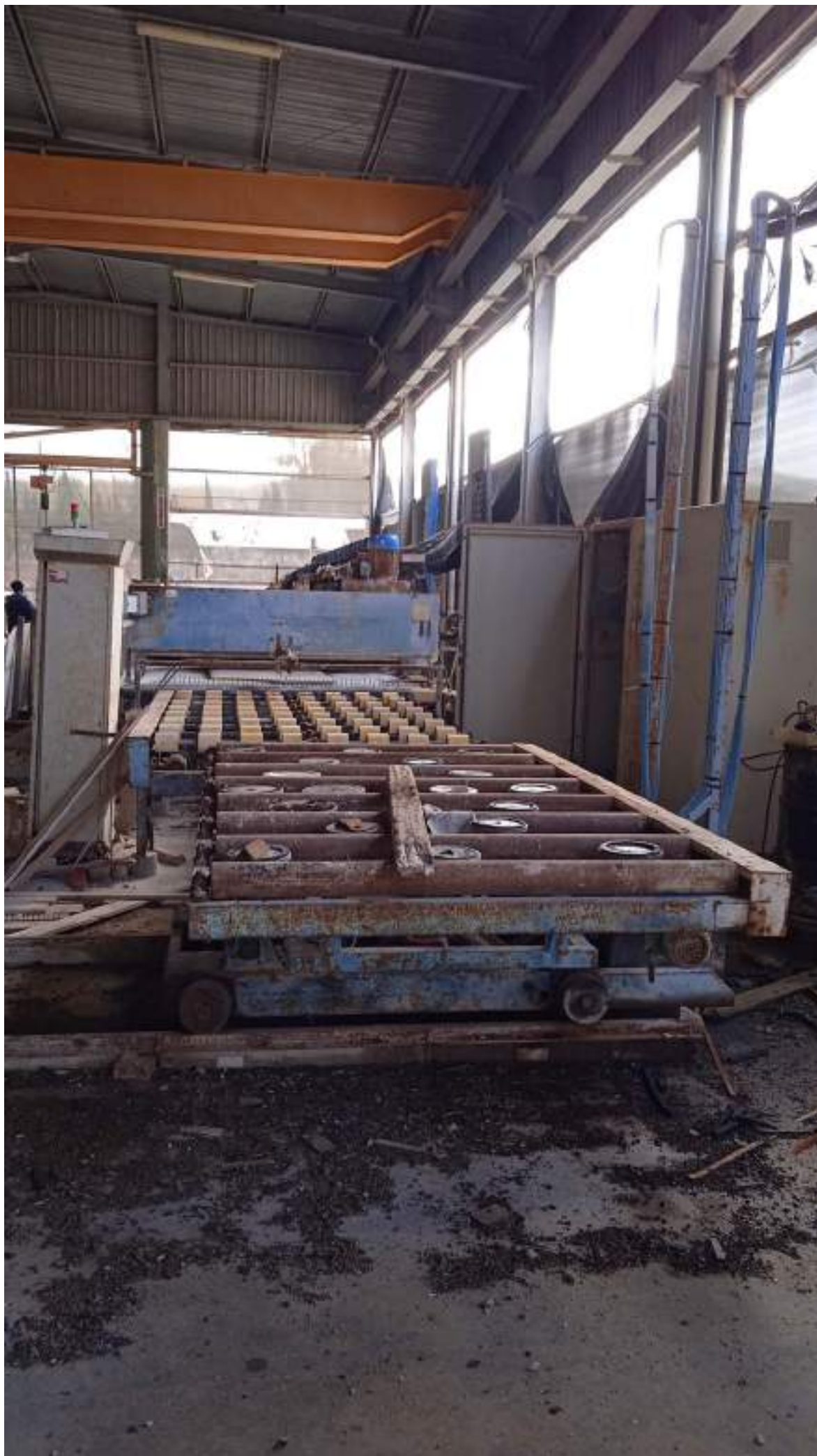
13. Impianto lucida lastre e quadri elettrici
