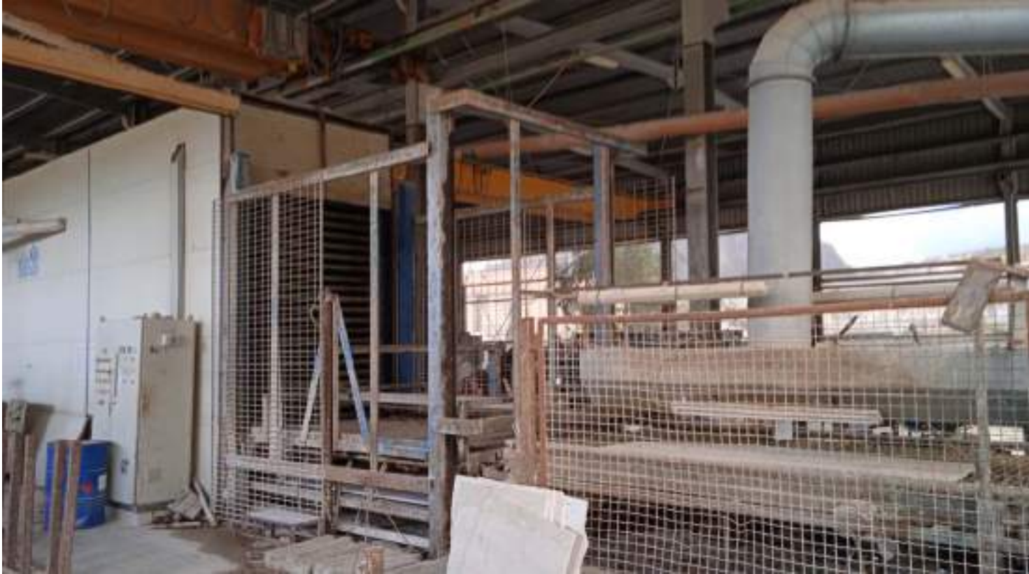
7. Forno per lastre con due gruette e quadro elettrico
