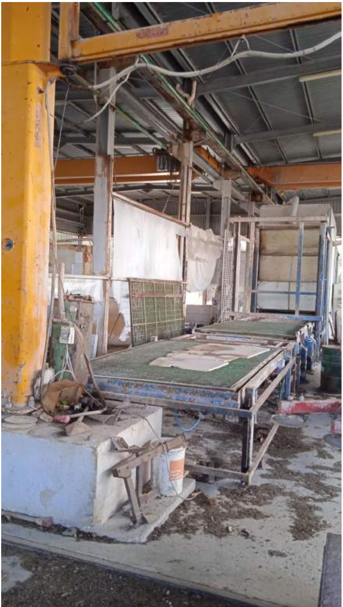
7. Forno per lastre con due gruette e quadro elettrico
