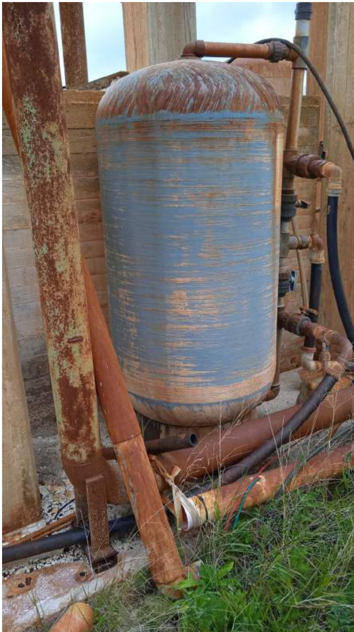
22. Impianto dissalatore SELMAR
