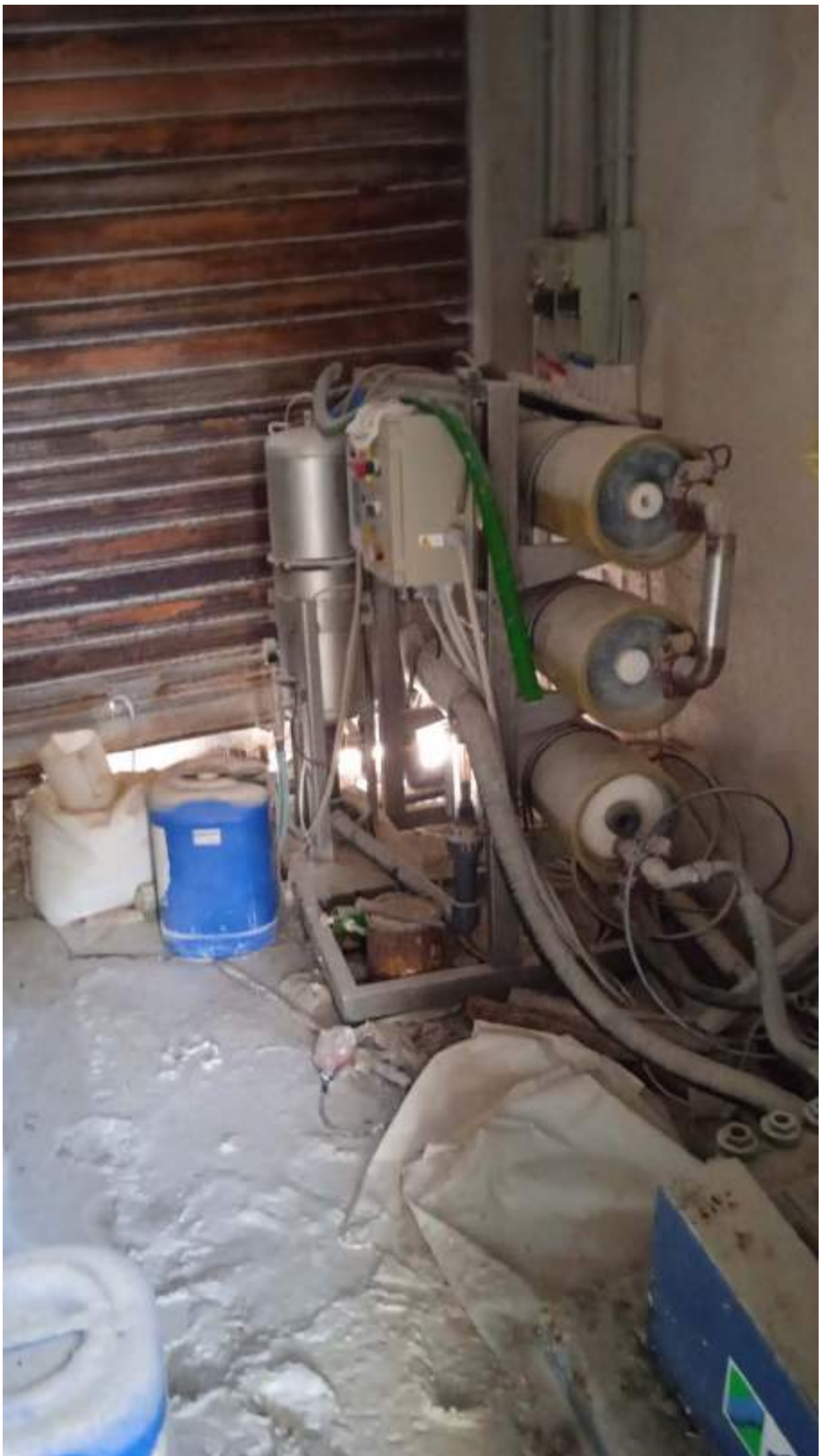
22. Impianto dissalatore SELMAR
