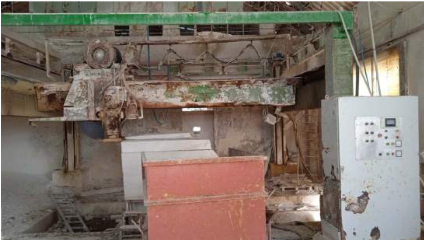
32. Taglia blocchi con quadro elettrico
